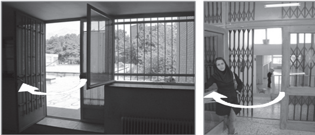
تصویر ۷: تصویری از مشخصات درب‌های خروج اضطراری
