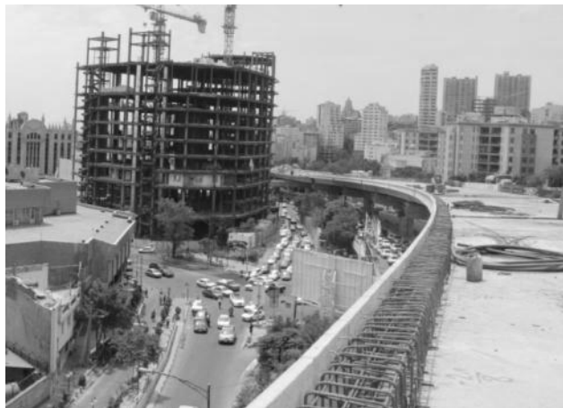
شکل ۱۰: تسلط ساختمان‌های اطراف بر بزرگراه صدر (تقاطع شریعتی با بزرگراه صدر)
